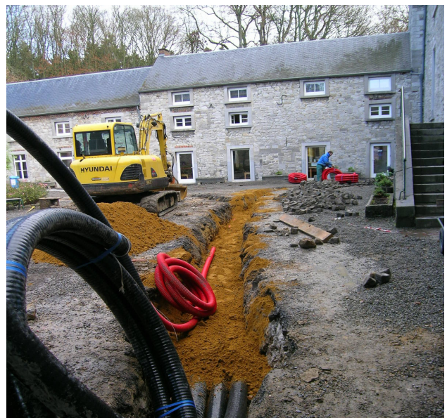
Pose du réseau de chaleur au départ de la chaudière vers les différents bâtiments, soit 121m de tuyaux enterrés
