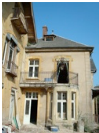
L'état du bâtiment a nécessité, entre autres, de refaire à neuf les enduits extérieurs (photo en cours de travaux)
