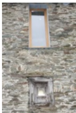
Les nouveaux percements réalisés en façade arrière conservent au mur sa massivité
