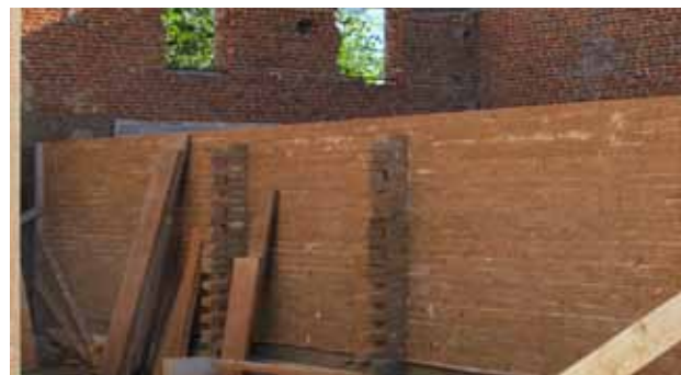
Ci-dessous: restauration de la grange et des étables; mur en briques de terre crue comprimée et stabilisée à la chaux ©Pierre Deru architecte-photographe
