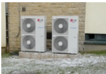
Les pompes à chaleur
